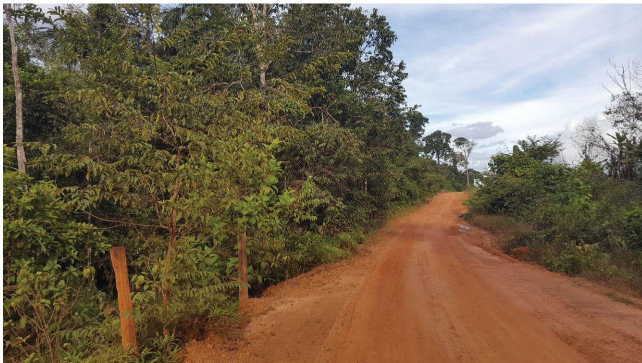
Foto 7 – BSTC para executar ( \varnothing 1,00 m). Trecho N° 2-3 - Coordenadas UTM: 8748440.09 m S e 709075.10 m E
