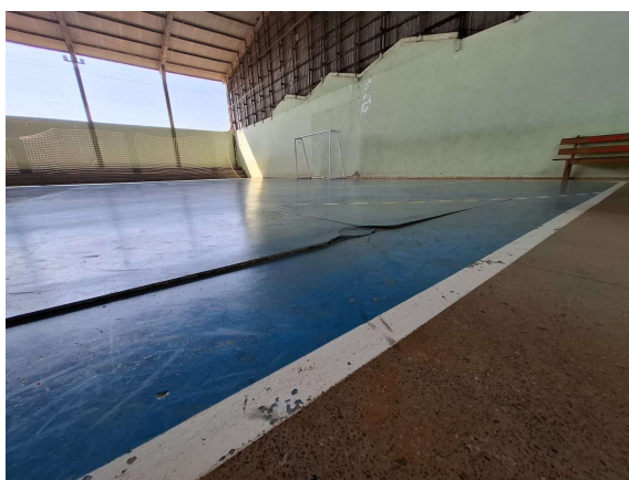
Foto 9 — fissura na quadra, próxima à marcação central.
