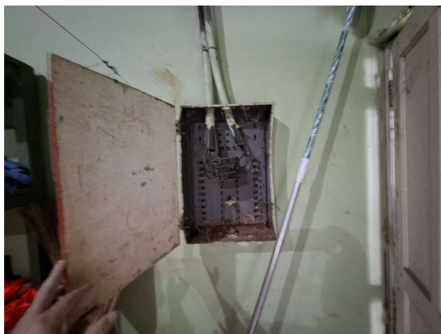
Foto 4 — quadro elétrico aberto, oxidado e com fiação exposta.
