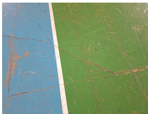
Foto 10 — detalhe da fissura atravessando as áreas azul e verde da quadra.
