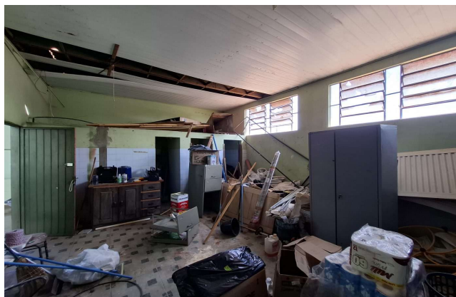
Foto 8 — depósito com materiais de limpeza, mobiliário, tintas e outros itens armazenados de forma desordenada, sob forro parcialmente danificado.
