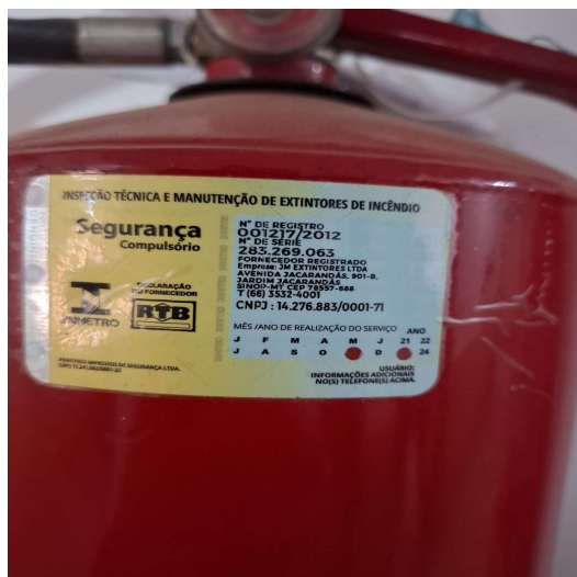
Foto 5 — etiqueta de inspeção e manutenção do extintor.
