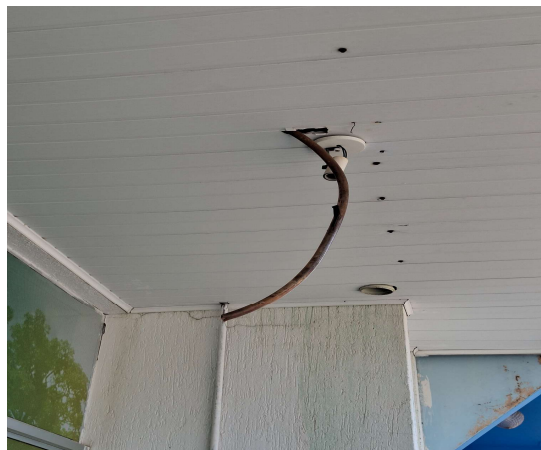
Foto 4 — mangueira de água do ar condicionado pendente no forro da área externa, próximo ao spot de iluminação.
