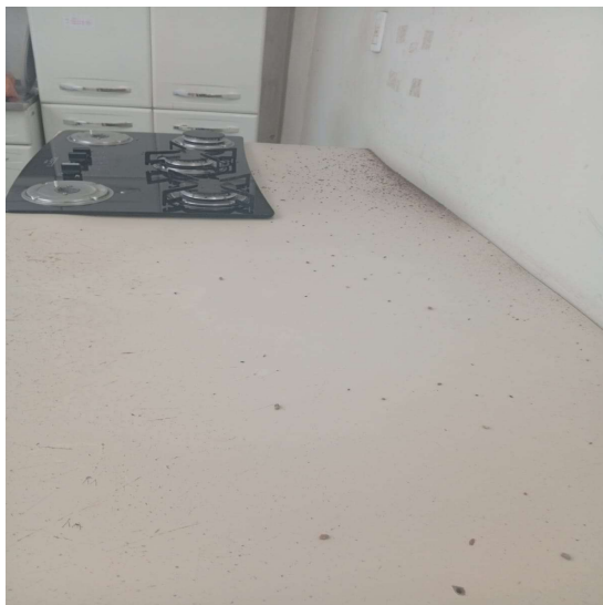
Foto 8 — resíduos atribuídos à presença de morcegos sobre a bancada da copa.
